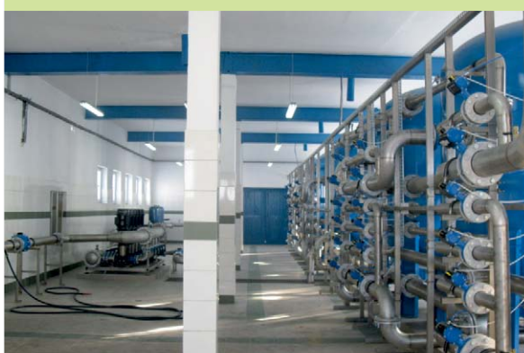
Stacja uzdatniania wody w miejscowości Rokitnica Nowa
