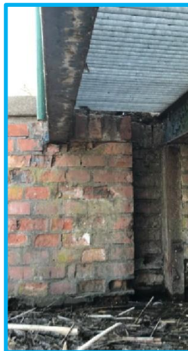
Jaz Antoniewo – uszkodzenia filaru środkowego, korozja (stan przed rozpoczęciem robót)
