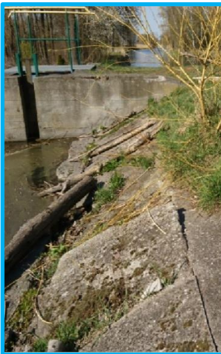
Jaz Antoniewo – uszkodzenia umocnień betonowych (stan przed rozpoczęciem robót)
