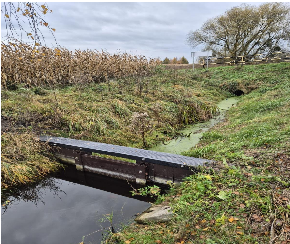
Zastawka na działce 134/4 na rowie melioracyjnym zwykłym w m. Wudzynek, powyżej użytku ekologicznego - rzędne zwierciadła wody w. górna= 91.233
