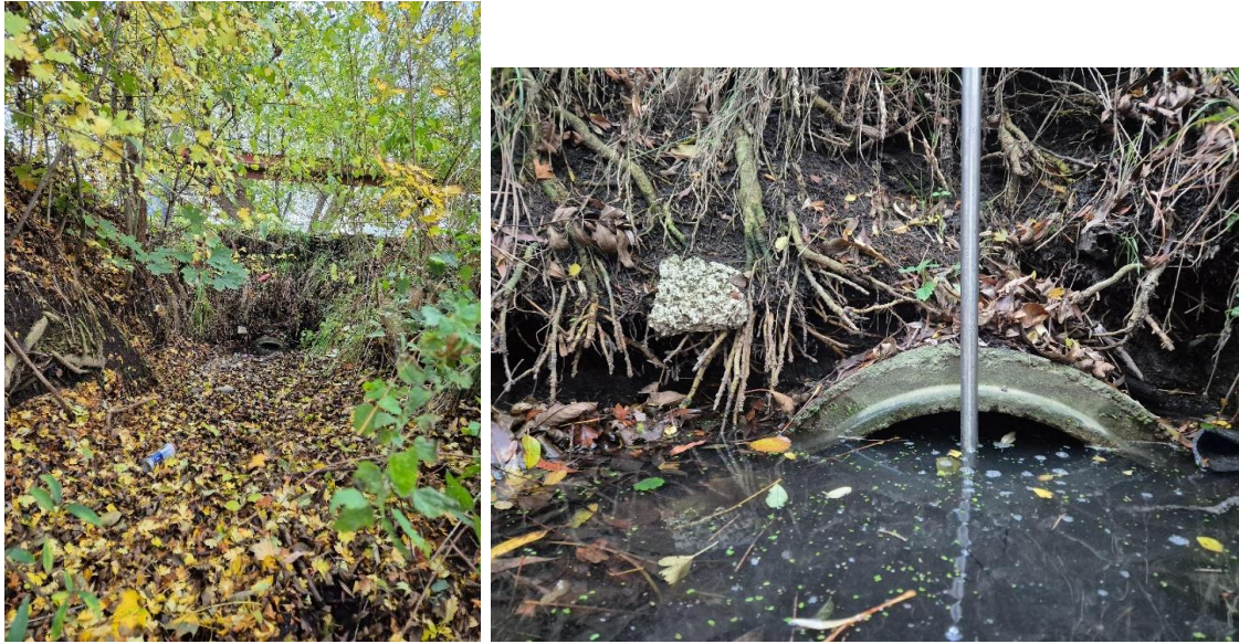
Fot. 6.4.1.2. Widok na fotografii od strony wody górnej wlotu do zbiornika – przepust o średnicy 50 cm pod jezdnią ul. M. Wodzyńskiej poniżej kładki/mostu. Przepust uszkodzony i zamulony w 50%.
