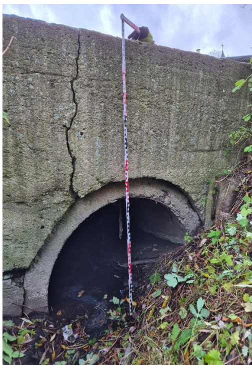
Fot. 6.4.1.5. Wylot z przepustu o średnicy 60 cm na wylocie ze zbiornika, widok od strony wody dolnej pod ulicą równoległą do ul. Brzeskiej. Przepust jest zamulony w 50% a jego wlot od strony zbiornika jest zablokowany.
