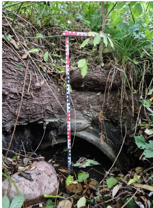
Fot. 6.4.1.3. Widok od strony wody dolnej wlotu do zbiornika – przepust o średnicy 50 cm pod jezdnią ul. M. Wodzyńskiej poniżej kładki/mostu. Przepust uszkodzony i zamulony w 50%.
