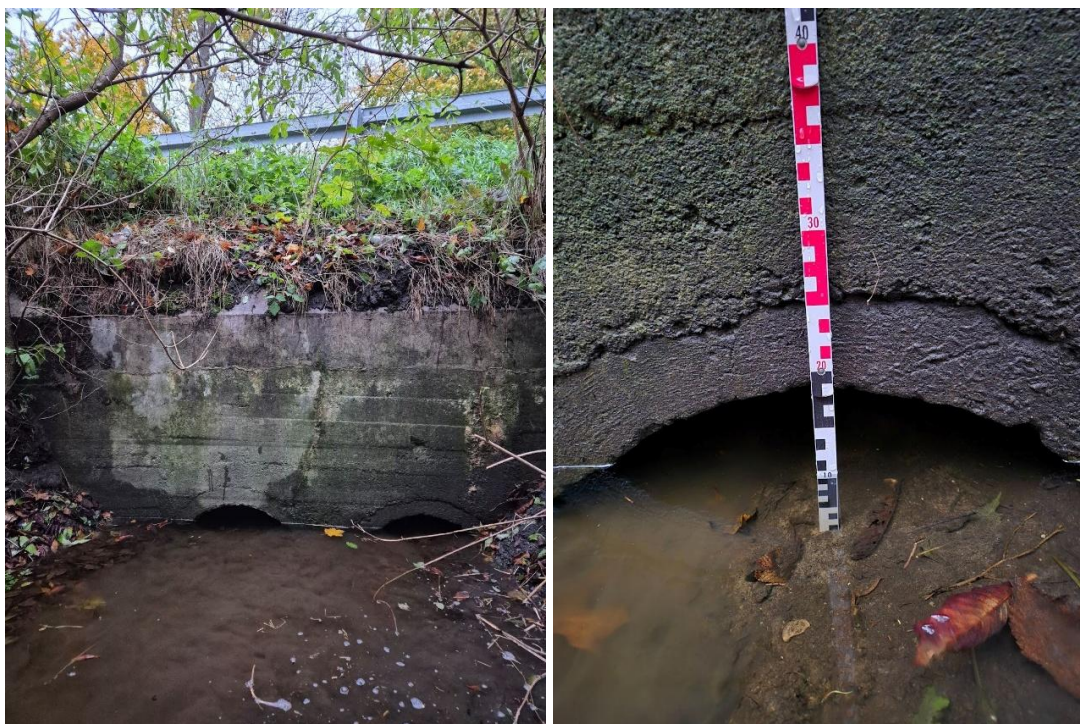
Fot. 6.4.2.6. Rów odprowadzający wodę ze zbiornika. Zamulone przepusty pod drogą gminną 266 (fot. 28.10.2025)
