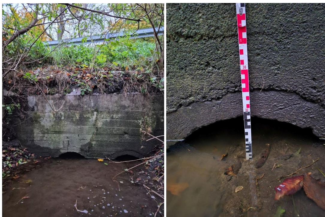
Fot. 6.4.2.6. Rów odprowadzający wodę ze zbiornika. Zamulone przepusty pod drogą gminną 266 (fot. 28.10.2025)
