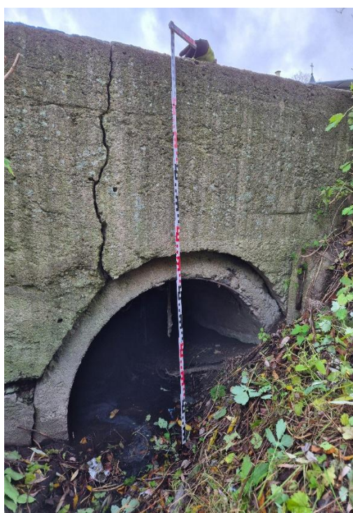
Fot. 6.4.1.5. Wylot z przepustu o średnicy 60 cm na wylocie ze zbiornika, widok od strony wody dolnej pod ulicą równoległą do ul. Brzeskiej. Przepust jest zamulony w 50% a jego wlot od strony zbiornika jest zablokowany.
