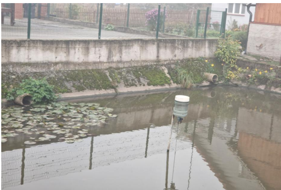
Fot. 6.4.1.6. Zbiornik zamulony w wschodniej części na około 20 cm, głębokość podczas wizyty terenowej 30.10.2025 r. wynosiła 55 cm. Połączony z rowem prowadzącym dopływ do Jeziora Górzyńskiego.
