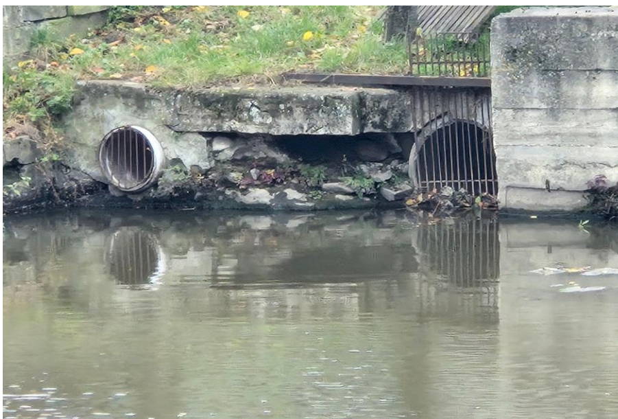
Fot. 6.4.1.5. Wloty wód ze zbiornika za pomocą do dwóch rurociągów kd300 mm i kd500 mm prowadzących wodę do rowu i jeziora - widok w kierunku ul. 11 Listopada.
