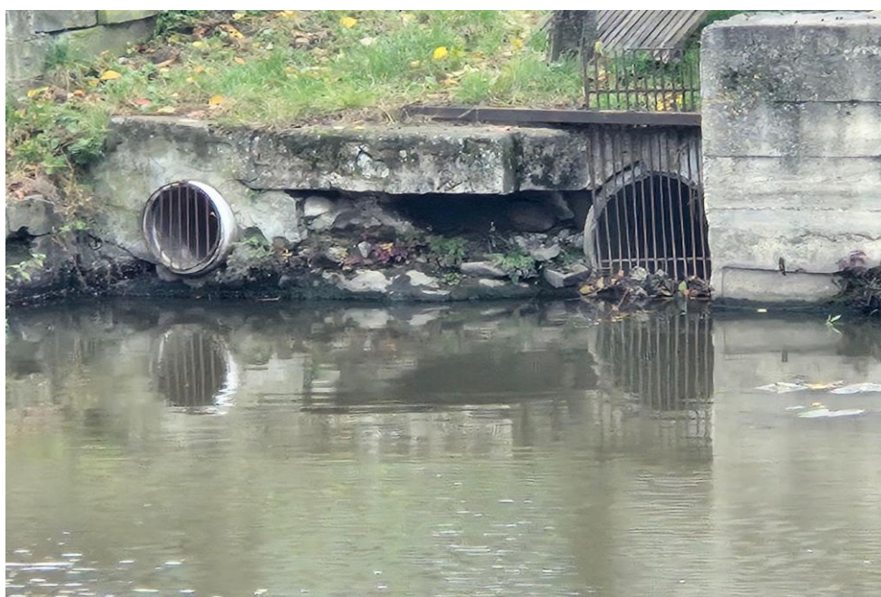
Fot. 6.4.1.5. Wloty wód ze zbiornika za pomocą do dwóch rurociągów kd300 mm i kd500 mm prowadzących wodę do rowu i jeziora - widok w kierunku ul. 11 Listopada.
