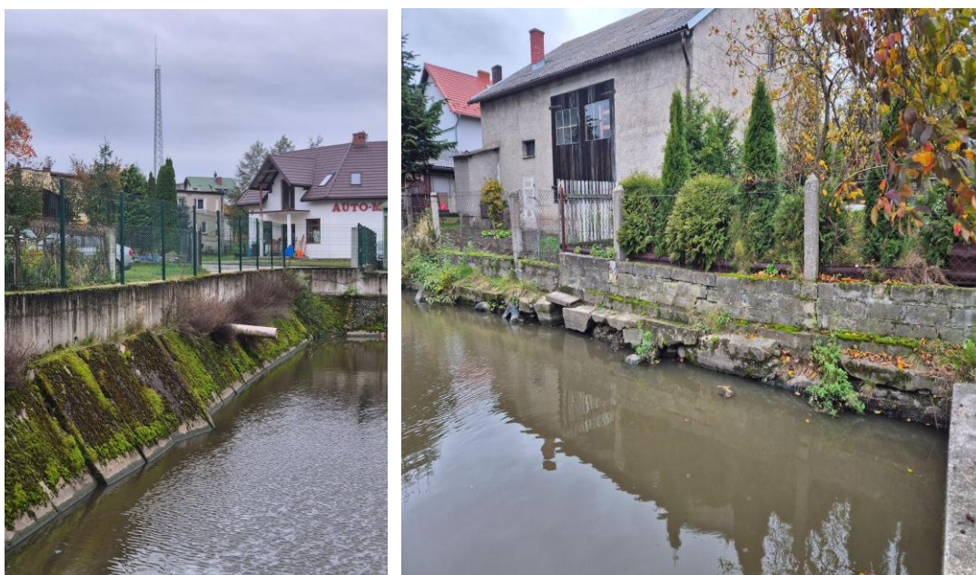
Fot. 6.4.1.3. Zły stan techniczny zbiornika. Uszkodzone umocnienie brzegowe wzdłuż ul. Matejki.
