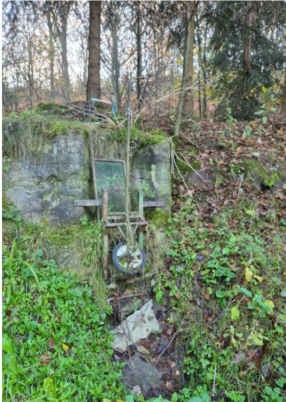
Fot. 6.4.1.6. Urządzenie na wylocie ze zbiornika nr
