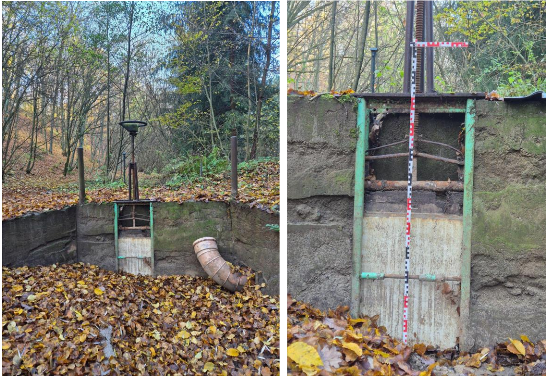
Fot. 6.4.1.4. Urządzenie na wlocie do Zbiornika nr 1. Dno zastawki 66,536 m 53°22'01.8101"N 18°44'35.6352"E.
