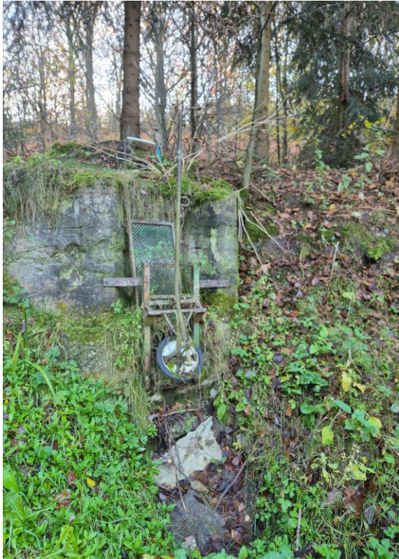
Fot. 6.4.1.6. Urządzenie na wylocie ze zbiornika nr
