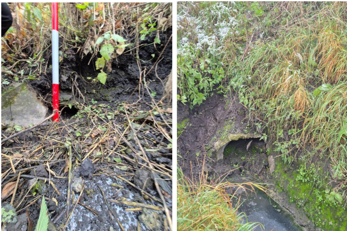
Fot. 6.4.1.3. Przepust n ciek n niedrożny powyżej i poniżej drogi na działce nr 54/2 (powyżej planowanych zbiorników)- część powyżej drogi uszkodzona i zamulona, poniżej drogi zamulona, dno przepustu 82.500 m n.p.m.
