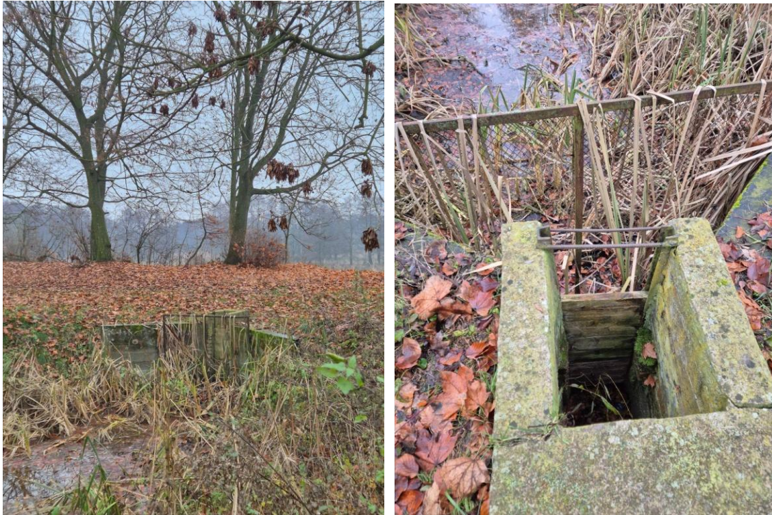
Fot. 6.4.2.7. Wlot do mnicha umożliwiającego odprowadzenie wody ze zbiornika nr 2 na działce 25/9 obręb Kołuda Wielka. Urządzenie do odbudowy - zastawka zamknięta i zamulona (70 cm mułu) (52°44'02.4456"N 18°09'17.9821"E). Rzędna dna wylotu 79.445 m n.p.m.
