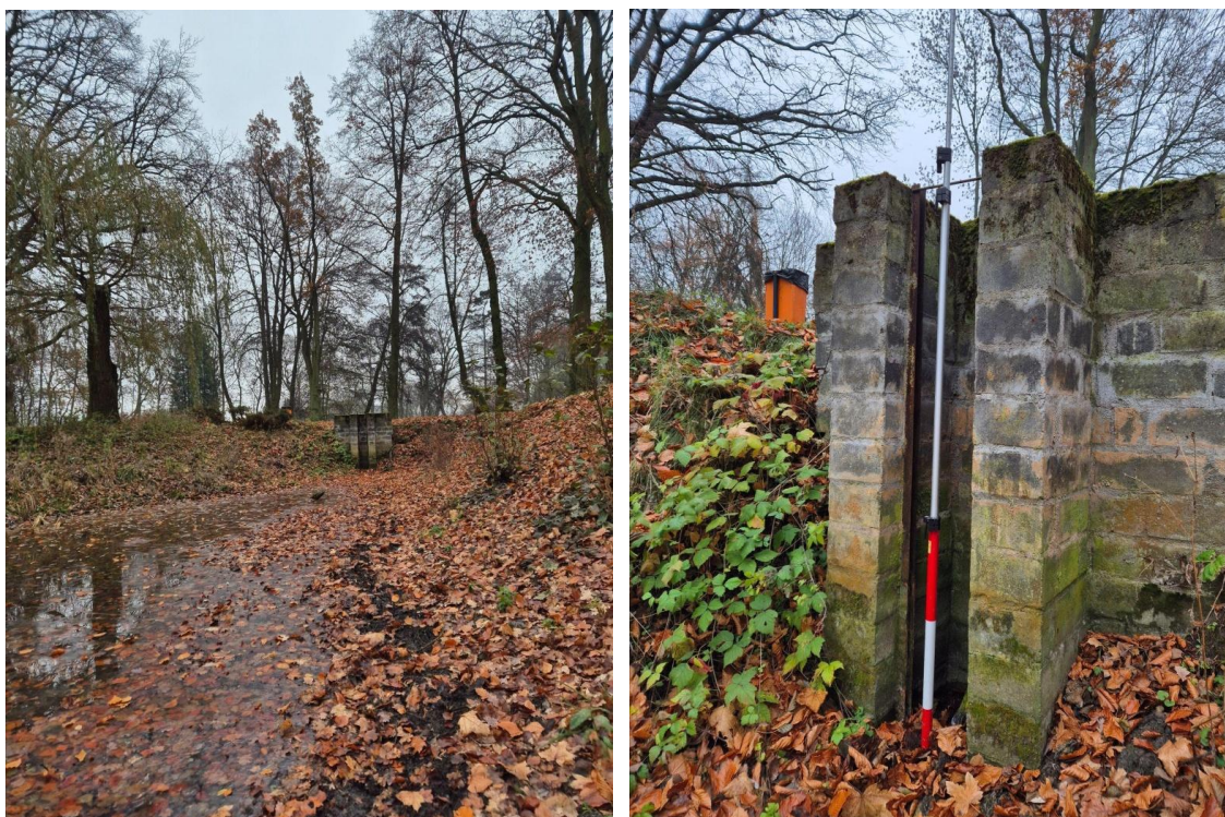
Fot. 6.4.2.3. Mnich na połączeniu zbiorników na działce 25/9, obręb Kołuda Wielka. Nieczynna, do odbudowy - dno zastawki = 79.829 m n.p.m. ( 52^{\circ}44'03.8419''\text{N} 18^{\circ}09'14.8404''\text{E} ).
