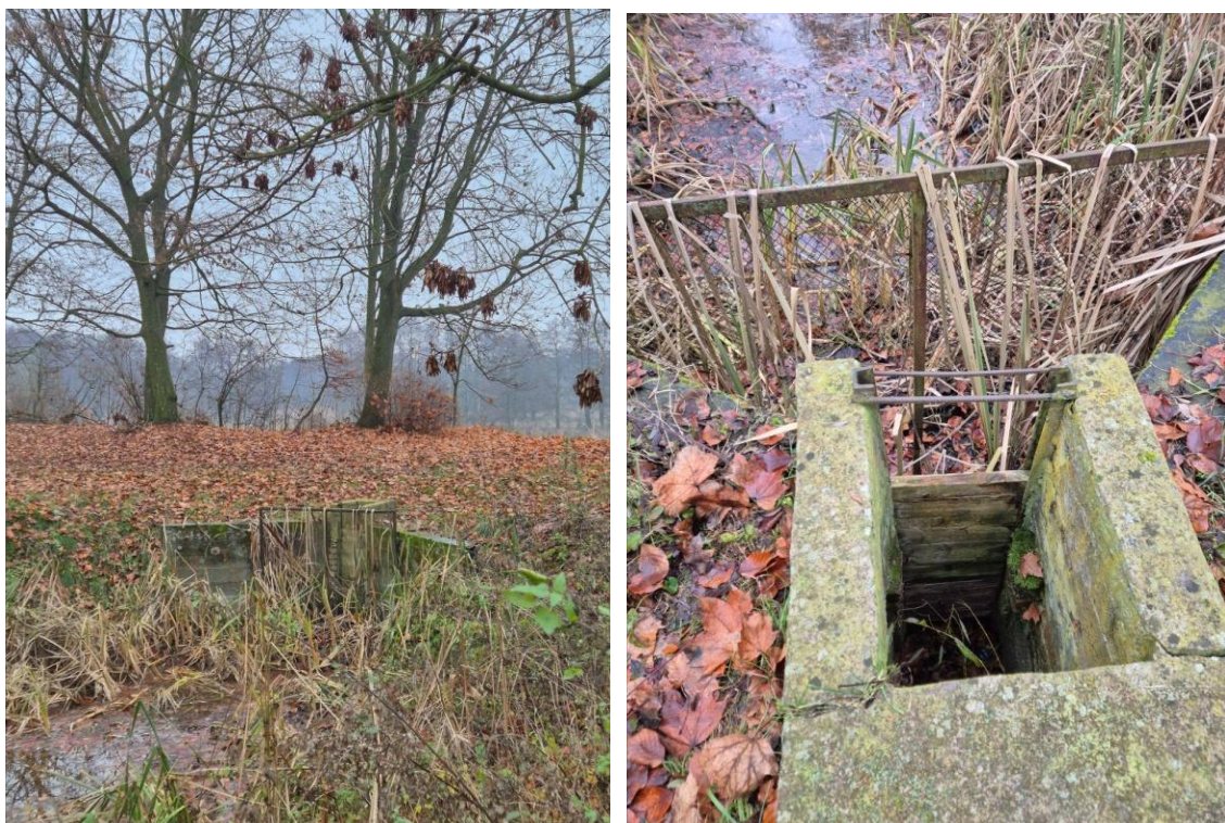
Fot. 6.4.2.7. Wlot do mnicha umożliwiającego odprowadzenie wody ze zbiornika nr 2 na działce 25/9 obręb Kołuda Wielka. Urządzenie do odbudowy – zastawka zamknięta i zamulona (70 cm mułu) (52°44'02.4456"N 18°09'17.9821"E). Rzędna dna wylotu 79.445 m n.p.m.
