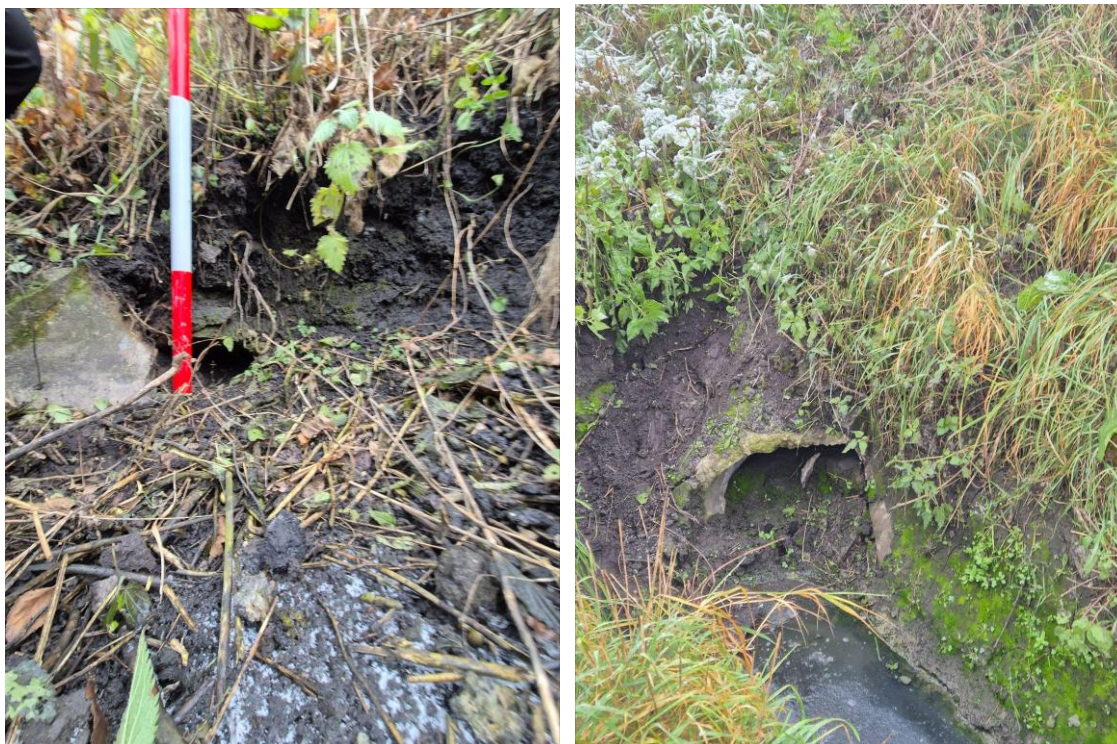
Fot. 6.4.1.3. Przepust n ciekuniedrożny powyżej i poniżej drogi na działce nr 54/2 (powyżej planowanych zbiorników) – część powyżej drogi uszkodzona i zamulona, poniżej drogi zamulona, dno przepustu 82.500 m n.p.m.
