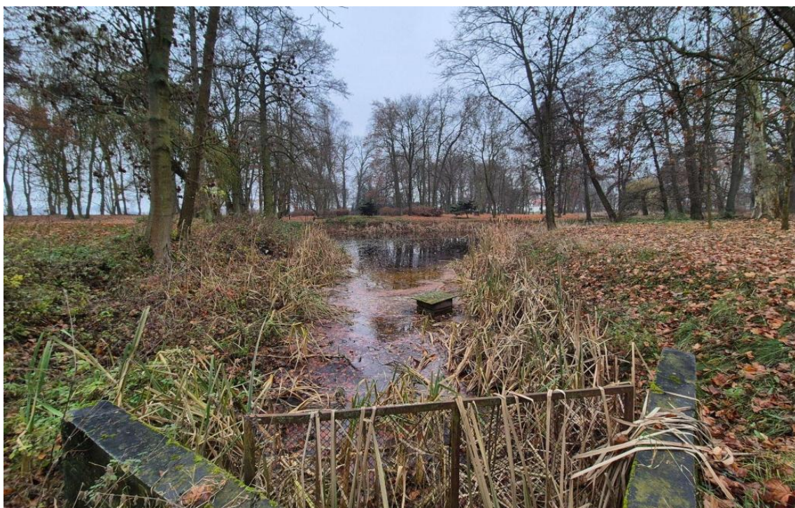
Fot. 6.4.2.6. Widok na czaszę zbiornika nr 2 w dolnej jego części na działce 25/9, obręb Kołuda Wielka. Wlot do mnicha umożliwiającego odprowadzenie wody ze zbiornika – urządzenie do odbudowy, zastawka zamknięta i zamulona (70 cm mułu) (52°44'02.4456"N 18°09'17.9821"E).
