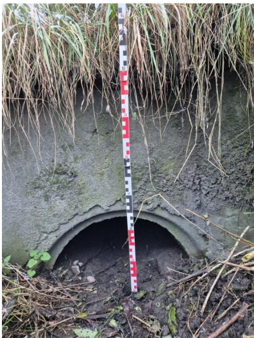
Fot. 6.4.1.7. Zamulony przepust doprowadzający wodę z rowu wzdłuż drogi powiatowej 3428C - dno rzędna 105.749 m n.p.m. (52°44'59.4226"N 19°23'50.2920"E).
