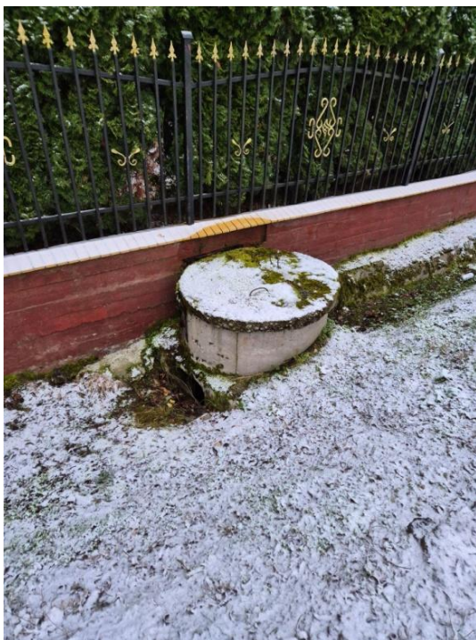
Fot. 6.4.1.6. Studnia po drugiej stronie drogi 3428C, zbiera wodę ze zbiornika oraz rowu wzdłuż drogi i dalej biegnie pod ziemią, dno wlotu z rowu = 105.513 m n.p.m. (52°44'59.0495"N 19°23'49.8984"E).
