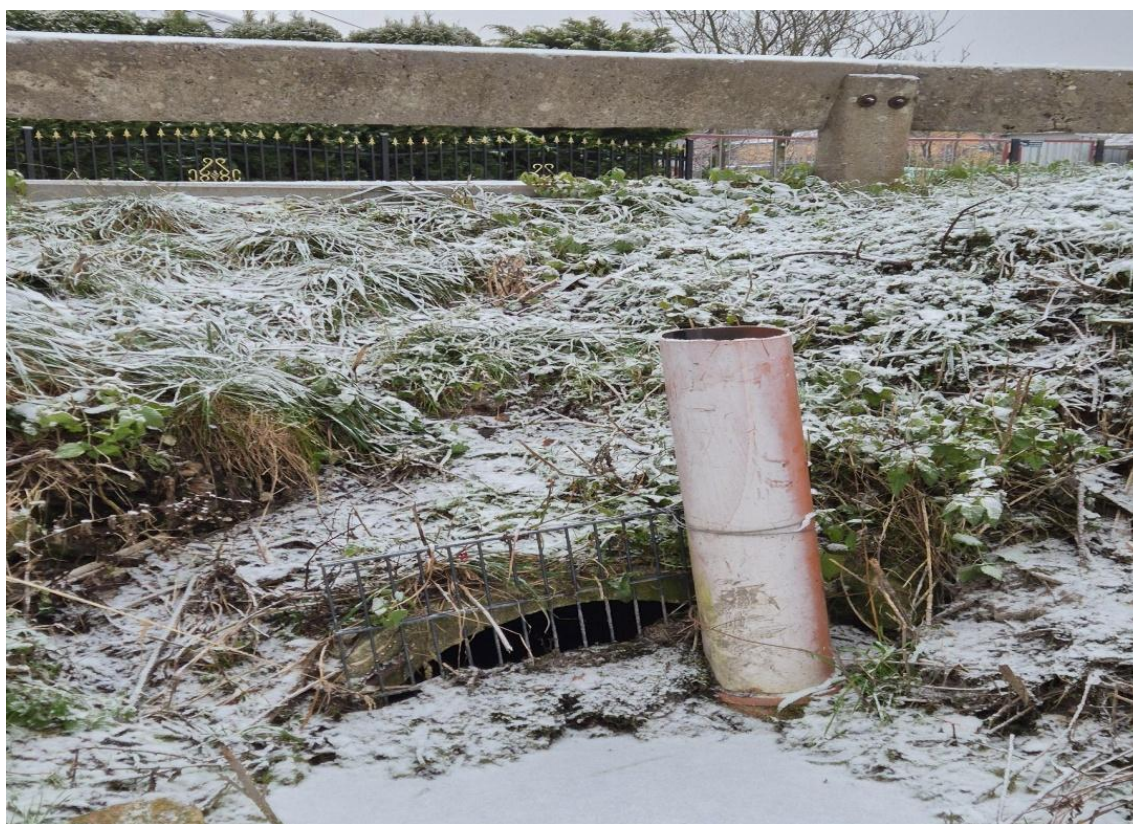
Fot. 6.4.1.3. Przepust pod droga gminną - dno odpływu = 105.236 m n.p.m. (zamulony w 2/3 i niedrożny) .
