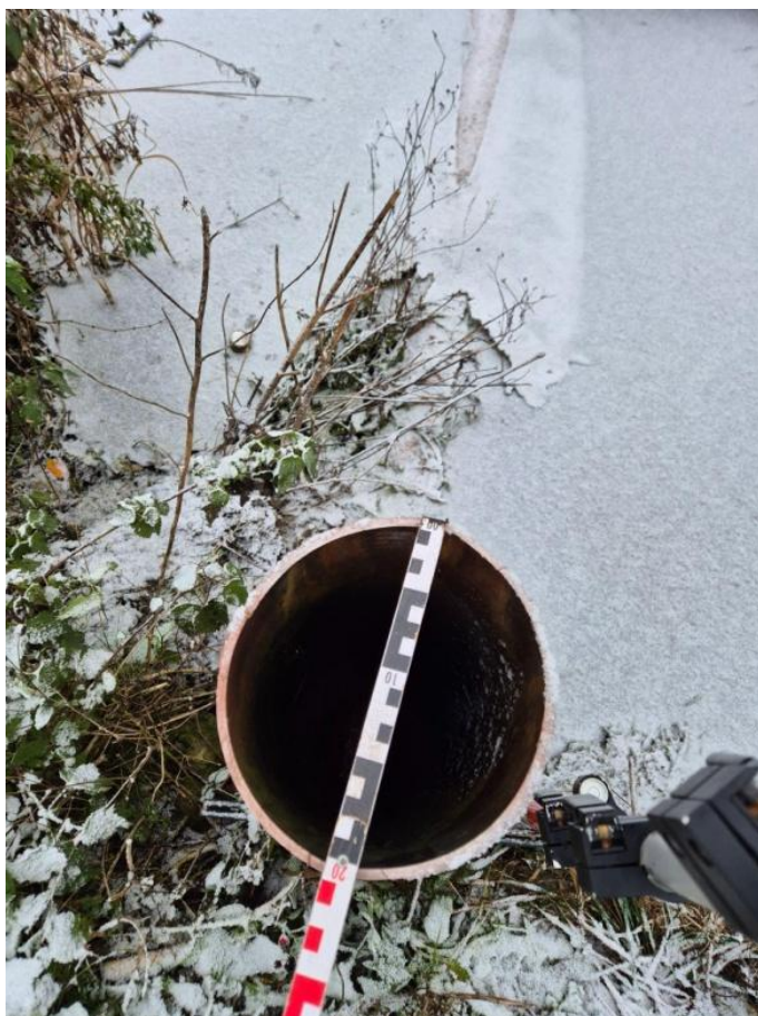
Fot. 6.4.1.5. Nadmiar wód ze zbiornika po jego spiętrzeniu do rzędnej drogi wpływa do rury PCV o średnicy 20 cm, dno rury = 105.317 m n.p.m.
