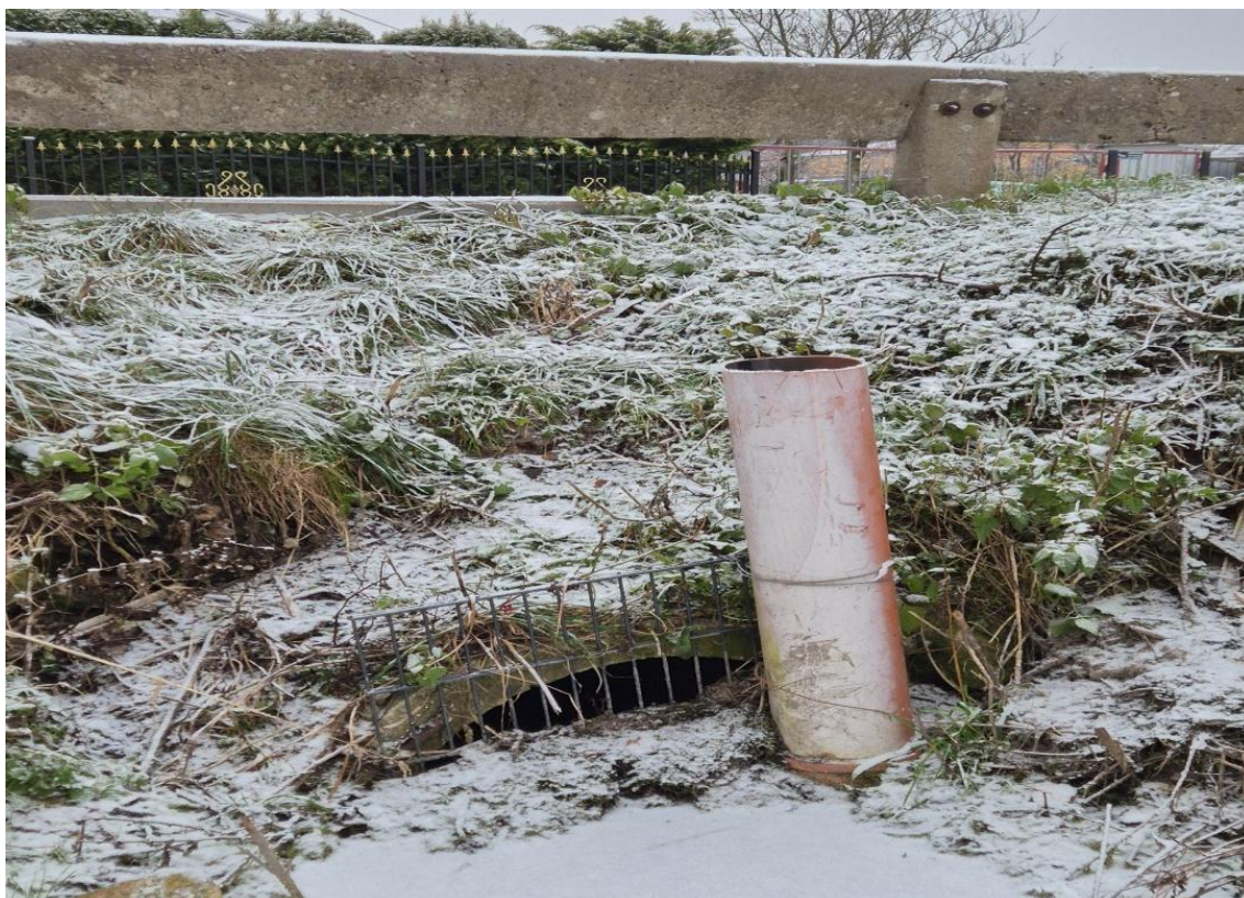
Fot. 6.4.1.3. Przepust pod droga gminną – dno odpływu = 105.236 m n.p.m. (zamulony w 2/3 i niedrożny).
