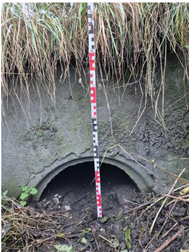
Fot. 6.4.1.7. Zamulony przepust doprowadzający wodę z rowu wzdłuż drogi powiatowej 3428C – dno rzędna 105.749 m n.p.m. ( 52^{\circ}44'59.4226''N 19^{\circ}23'50.2920''E ).
