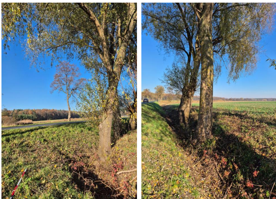
Fot. 6.4.1.5. Stan rowu w miejscu przerzutu wody działka 247/4, obręb Wójcin.
