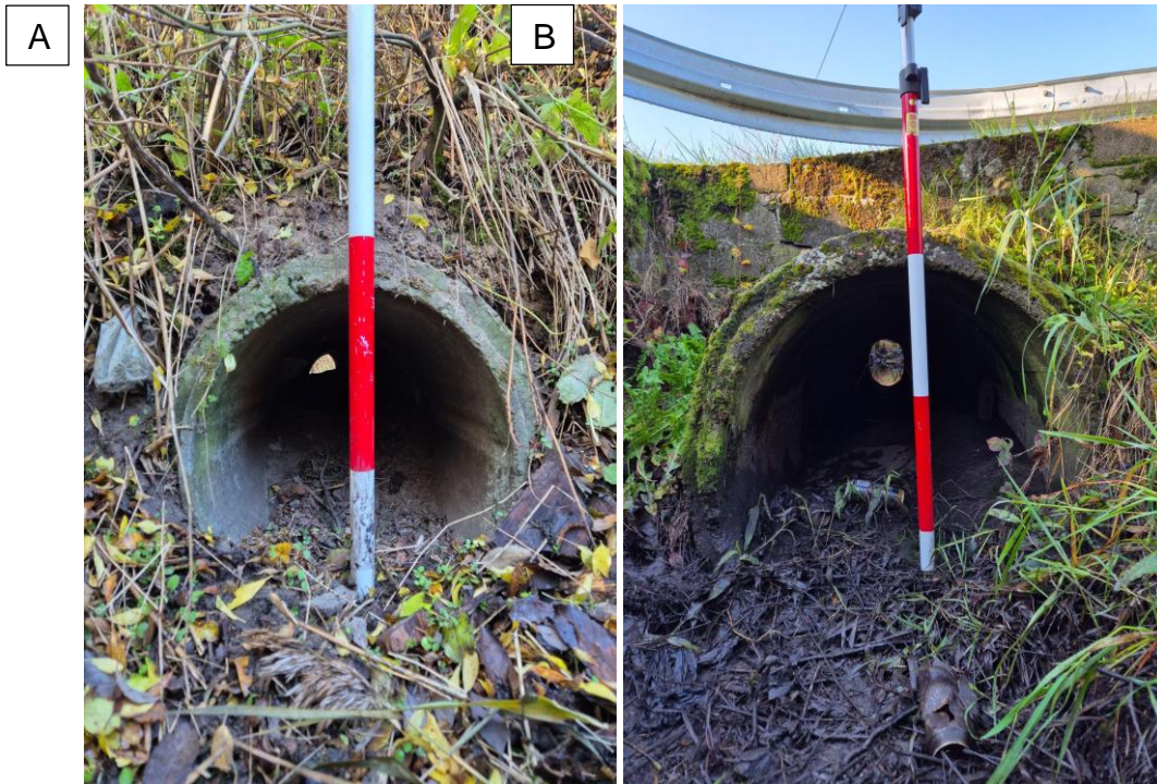
Fot. 6.4.1.4. Przepusty o średnicy 120 cm na rowie doprowadzającym wodę do Jeziora w m. Bartodziejewice
