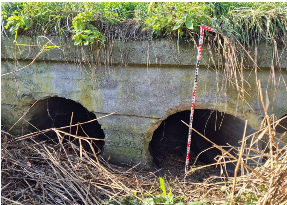
Fot. 6.4.1.3. Przepust podwójny o średnicy 120 cm na rowie doprowadzającym wodę do Jeziora - dno 99.268, 52°31'43.3026"N 18°10'55.8486"E.
