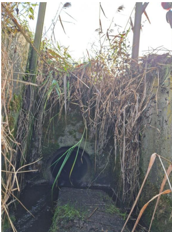
Fot. 6.4.2.1. Przykładowe zastawki - większość pozbawiona metalowych zasuw, a tam gdzie one są, to podobno albo bardzo ciężko chodzą albo wcale są nie do ruszenia na działce 174/1.
