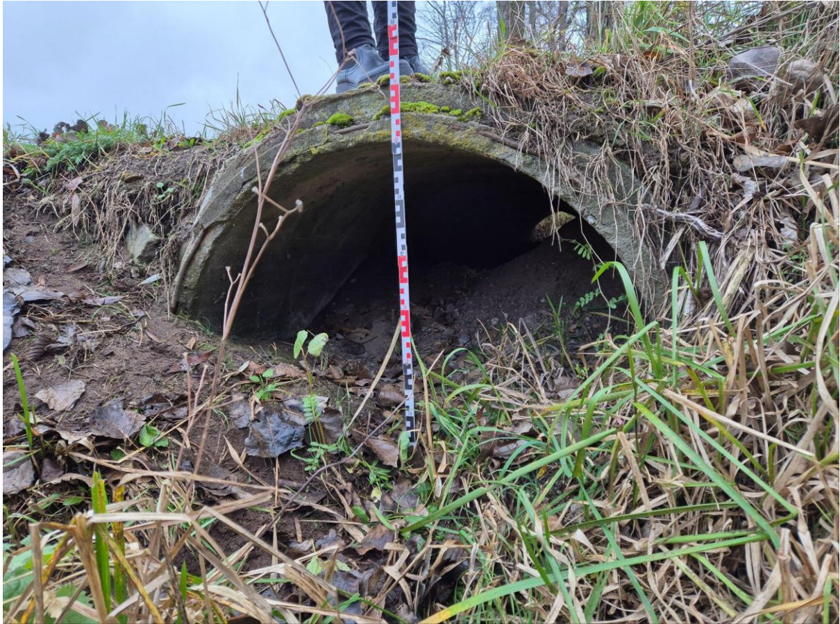
Fot. 6.4.2.6. Rów nr 5, przepust w połowie zasypany/zamulony, obecnie dno przepustu 99.427 m n.p.m., ale faktycznie około 98.827 m n.p.m. 52°25'55.9439"N, 18°41'48.4534"E, lustro wody = 99.104 m n.p.m. dno rowu przed oczkiem = 99.317 m n.p.m.
