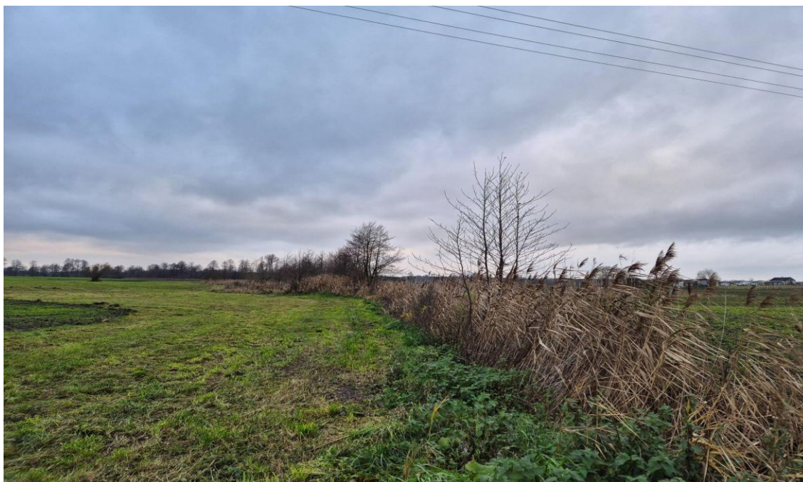
Fot. 6.4.2.9. Rów nr 7, poniżej przepustu. W 2016/2017 rów wylał, zalało okoliczne pola i prawie podtopiło okoliczne budynki.
