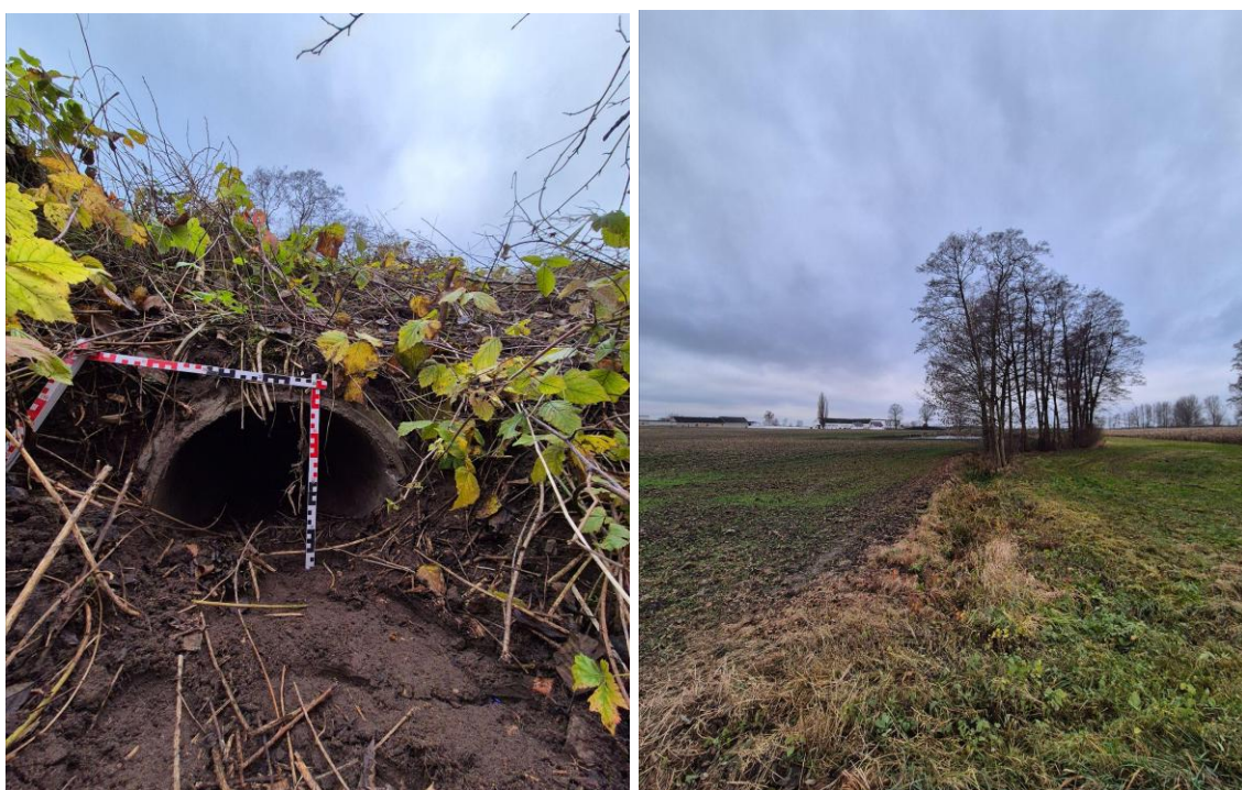
Fot. 6.4.2.10. Rów nr 7, dno rowu = 100.069 m n.p.m., przepust \varnothing 60 cm, zamulony prawie w połowie, dno przepustu gdzieś w okolicach 99.819 m n.p.m. 52°26'09.9104"N, 18°41'57.4256"E
