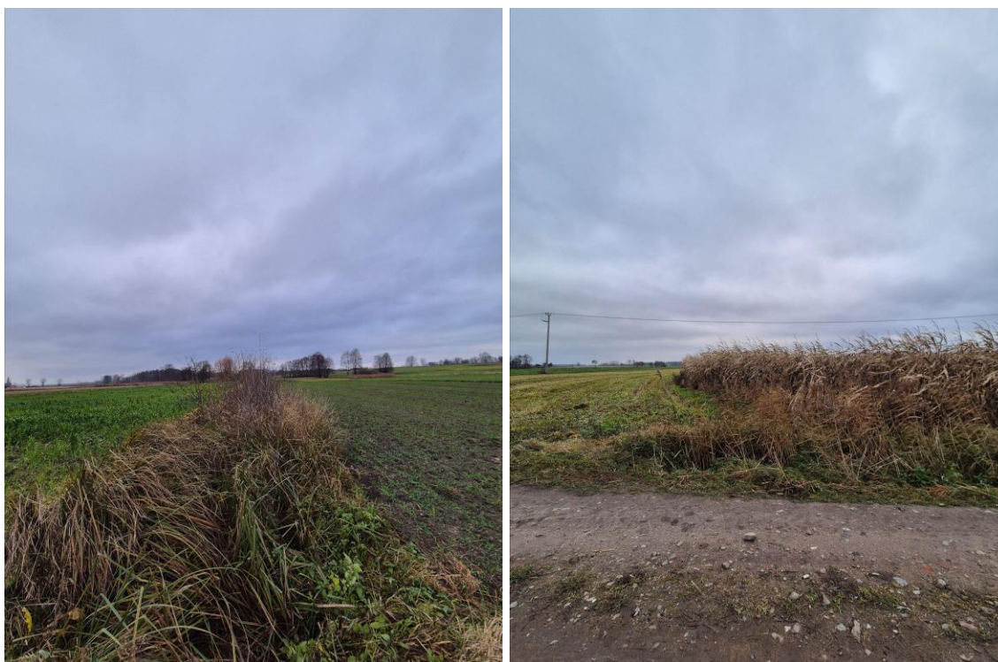
Fot. 6.4.2.1. Rów nr 2. dno rowu = 102.576 m n.p.m. 52°26'03.7136"N, 18°42'28.2553"E; rów zarośnięty, przepust uszkodzony i niedrożny zostały tylko kawałki betonu, po drugiej stronie rowu brak - rolnik zasypał, rośnie kukurydza
