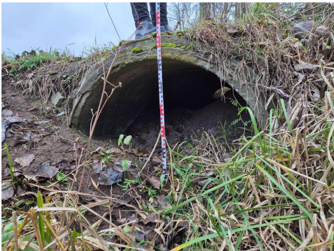
Fot. 6.4.2.6. Rów nr 5, przepust w połowie zasypany/zamulony, obecnie dno przepustu 99.427 m n.p.m., ale faktycznie około 98.827 m n.p.m; 52°25'55.9439"N, 18°41'48.4534"E, lustro wody = 99.104 m n.p.m. dno rowu przed oczkiem = 99.317 m n.p.m.
