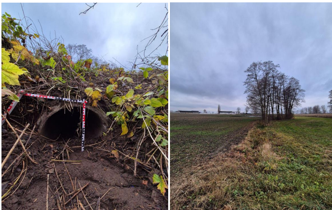
Fot. 6.4.2.10. Rów nr 7, dno rowu = 100.069 m n.p.m., przepust \varnothing 60 cm, zamulony prawie w połowie, dno przepustu gdzieś w okolicach 99.819 m n.p.m; 52°26'09.9104"N, 18°41'57.4256"E
