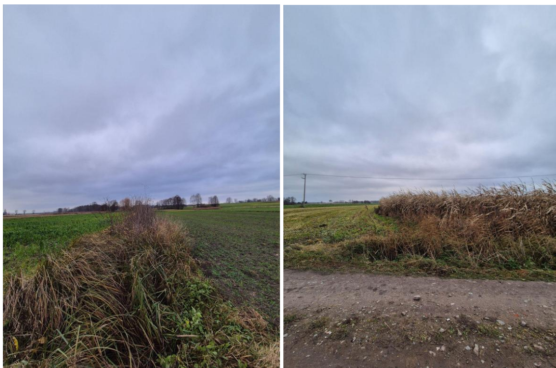
Fot. 6.4.2.1. Rów nr 2. dno rowu = 102.576 m n.p.m; 52°26'03.7136"N, 18°42'28.2553"E; rów zarośnięty, przepust uszkodzony i niedrożny zostały tylko kawałki betonu, po drugiej stronie rowu brak – rolnik zasypał, rośnie kukurydza.
