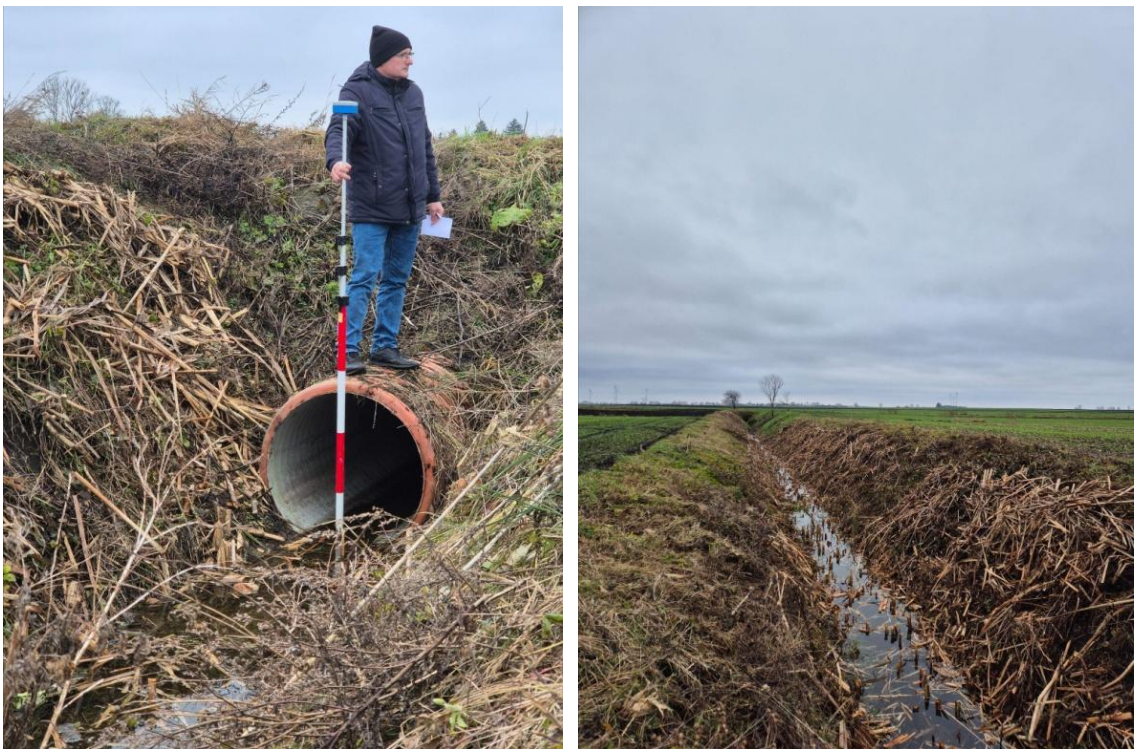
Fot. 6.4.1.1. Rów BA1 – Szostka w profilu projektowanej zastawki oraz powyżej przepustu, gdzie planowana jest zastawka (dz. nr 118/1 i 223). Dno przepustu = 92.627 m, średnica 80 cm (52°40'10.6626"N, 18°29'18.4952"E). Wypełnienie wody w rowie wynosiło 5 cm.
