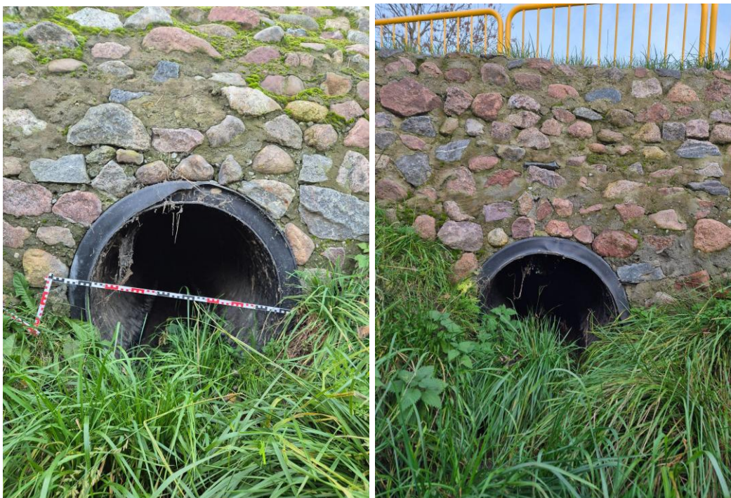
Fot. 6.4.2.1. Zestaw dwóch przepustów (pod drogą Długie – Rakowo, działka nr 8, i drugi pod ścieżką rowerową).
