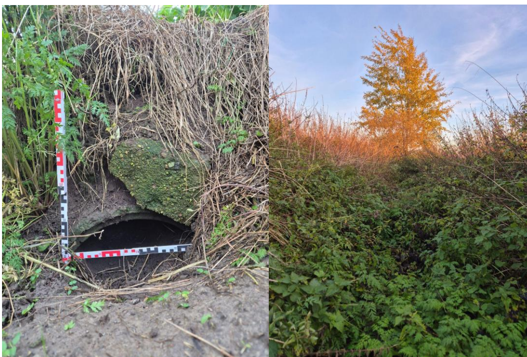
Fot. 6.4.2.2. Włot do rurociągu biegnącego w kierunku północnym (po lewej); Rów otwarty na działce 9/3 obręb Czyżewo 53^{\circ}05'38.3883'' N, 19^{\circ}19'51.6083'' E, dno rowu - rzędna 109.317 m n.p.m (po prawej).
