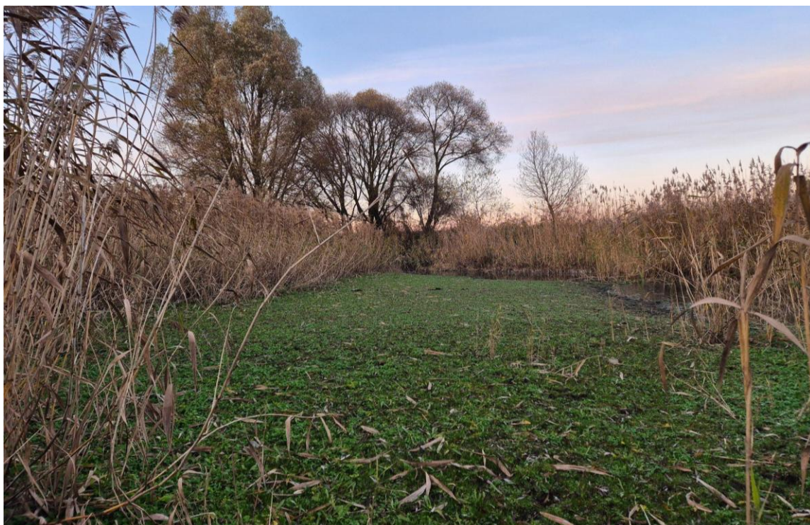
Fot. 6.4.2.3. Zamulona i zarośnięta czasza zbiornika na dz. nr 11/11 obręb Czyżewo, zwierciadło wody 108.642 m n.p.m. 53°05'27.8208" N, 19°19'50.2016" E
