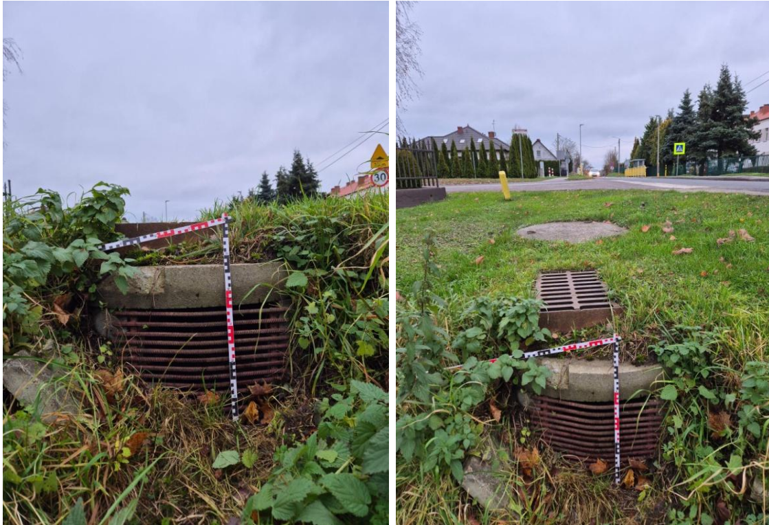
Fot. 6.4.2.2. Przepusty i wloty do kanalizacji deszczowej przy ul Sępoleńskiej, m. Gostycyn.
