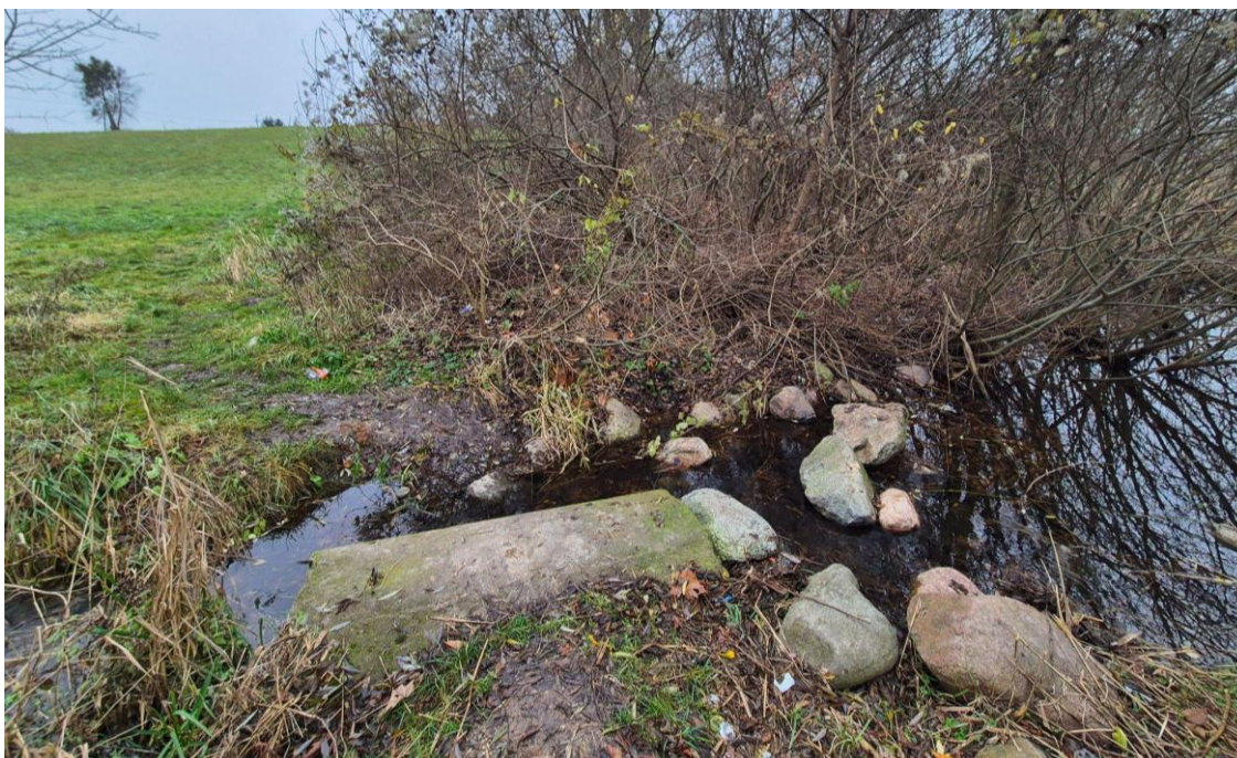
Fot.6.4.1.7. Prowizoryczna blokada odpływu z jeziora Frydek.
