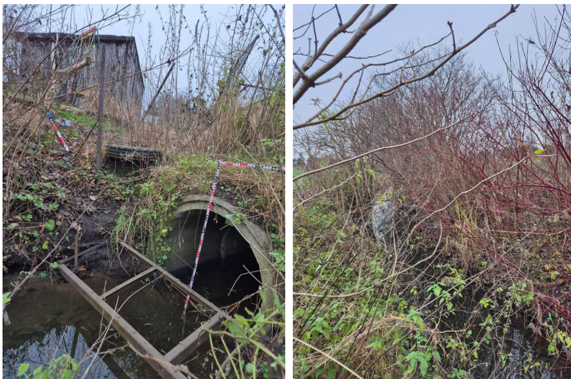
Fot. 6.4.1.3. Wlot wód rowu Wh do przepustu na działce 17 obręb 0007. Dno przepustu na wlocie = 93.843 m n.p.m. ( 53^{\circ}16'34.4038''N 18^{\circ}56'07.8176''E ), lustro wody = 94.052 m n.p.m.
